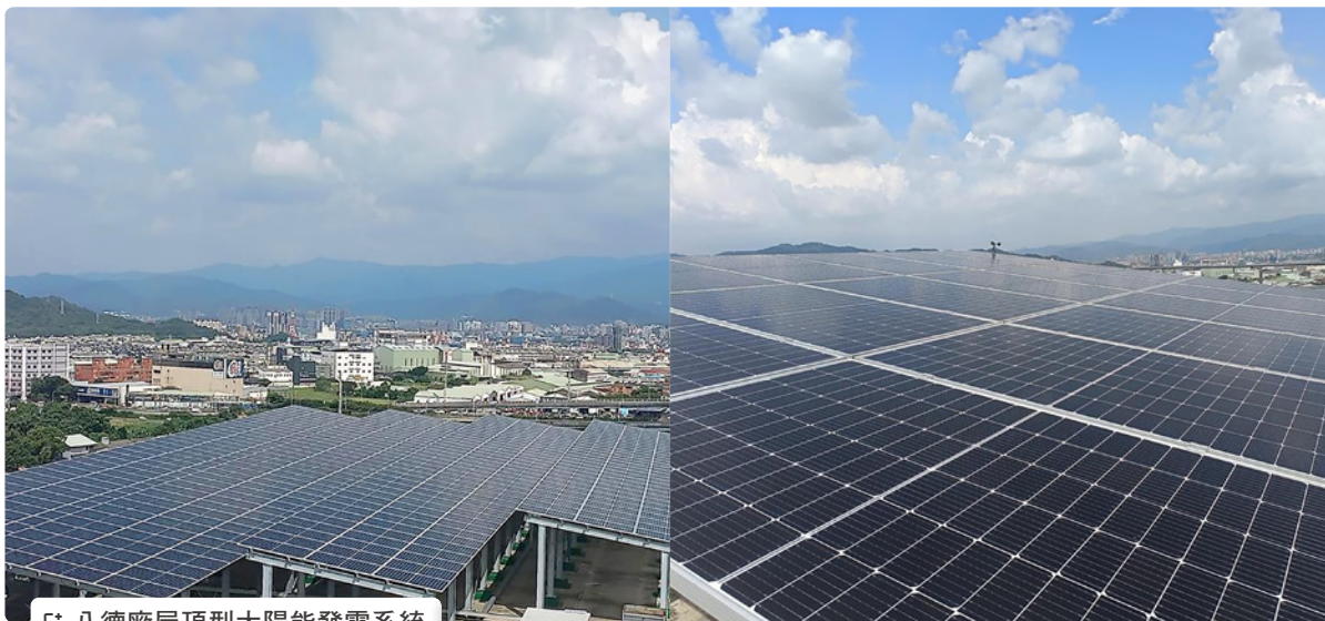
八德廠屋頂型太陽能發電系統
