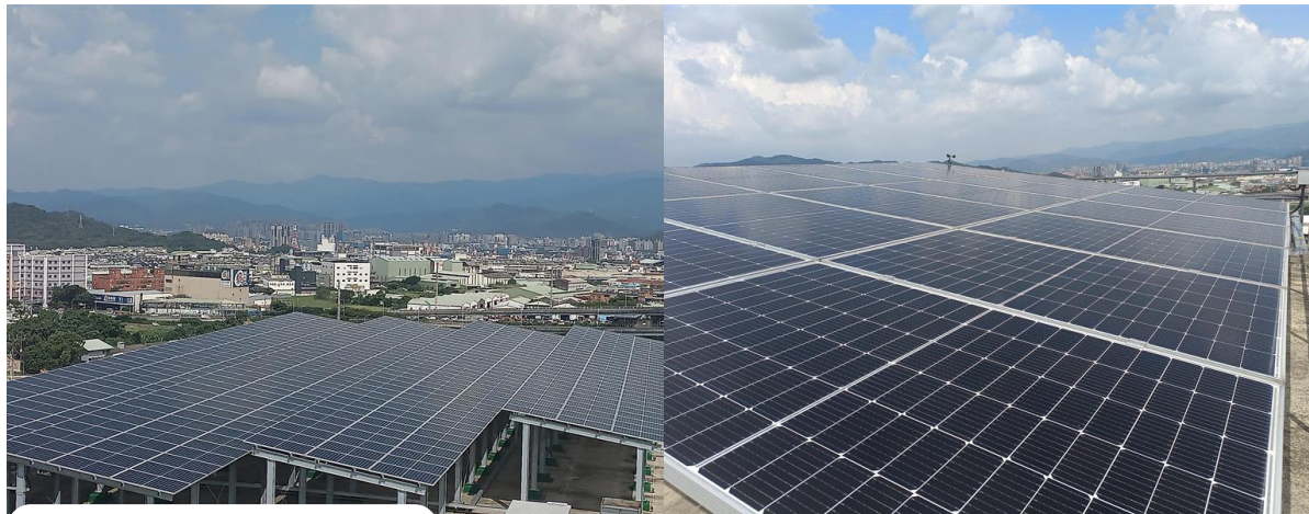
◎ 八德廠屋頂型太陽能發電系統
