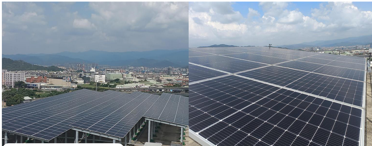
◎ 八德廠屋頂型太陽能發電系統
